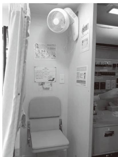
更衣室内サーキュレーター
